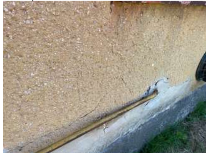
Lábazat máladozik, - szigetelés hiányos
