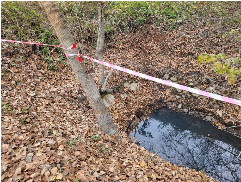
6. kép: Az iszapfogó Zsilippel ellentétes vége: a csatlakozó áteresz a földutat és a vízvezetékeket is keresztezi - hrsz: 0251
