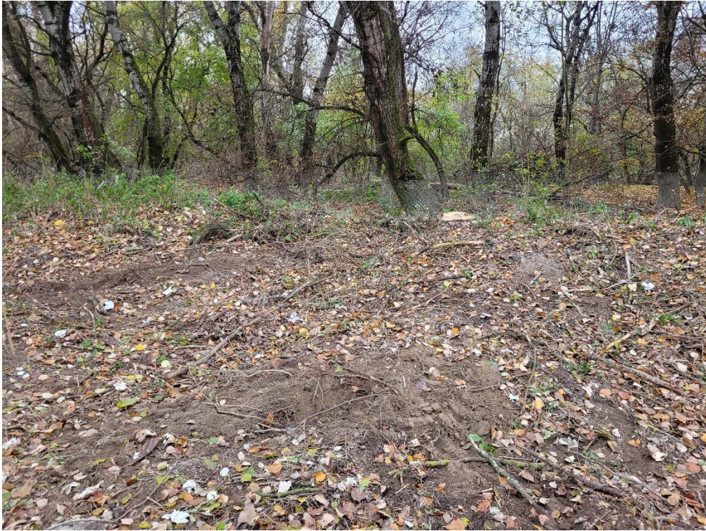
9. kép: Átszakadt árvízvédelmi töltés a Dunai Holtág mellett – hrsz: 0251
