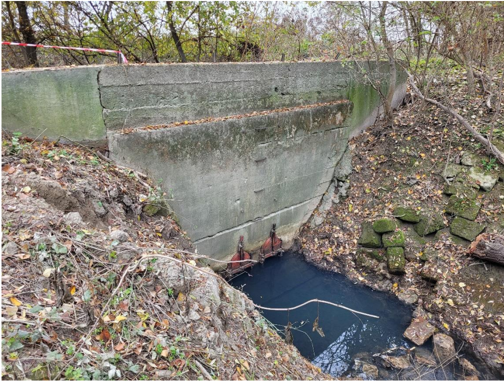
1. kép: Zsilip alvízi oldala, sérült támfal - hrsz: 0251
