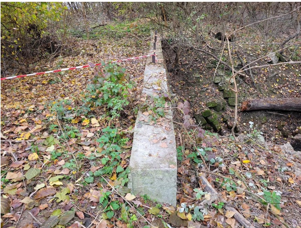
2. kép: Zsilip alvízi oldala, sérült támfal - hrsz: 0251
