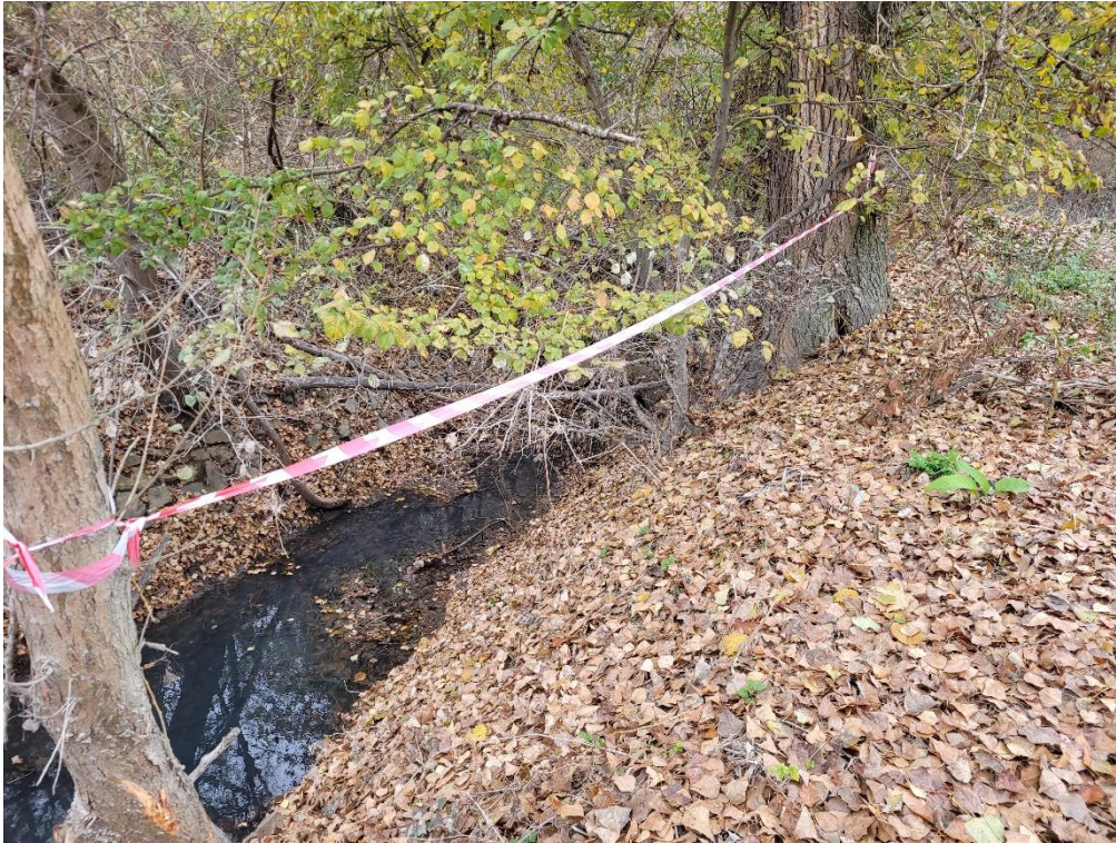
5. kép: Iszapfogó a Zsilip felvízi oldalán - hrsz: 0251
