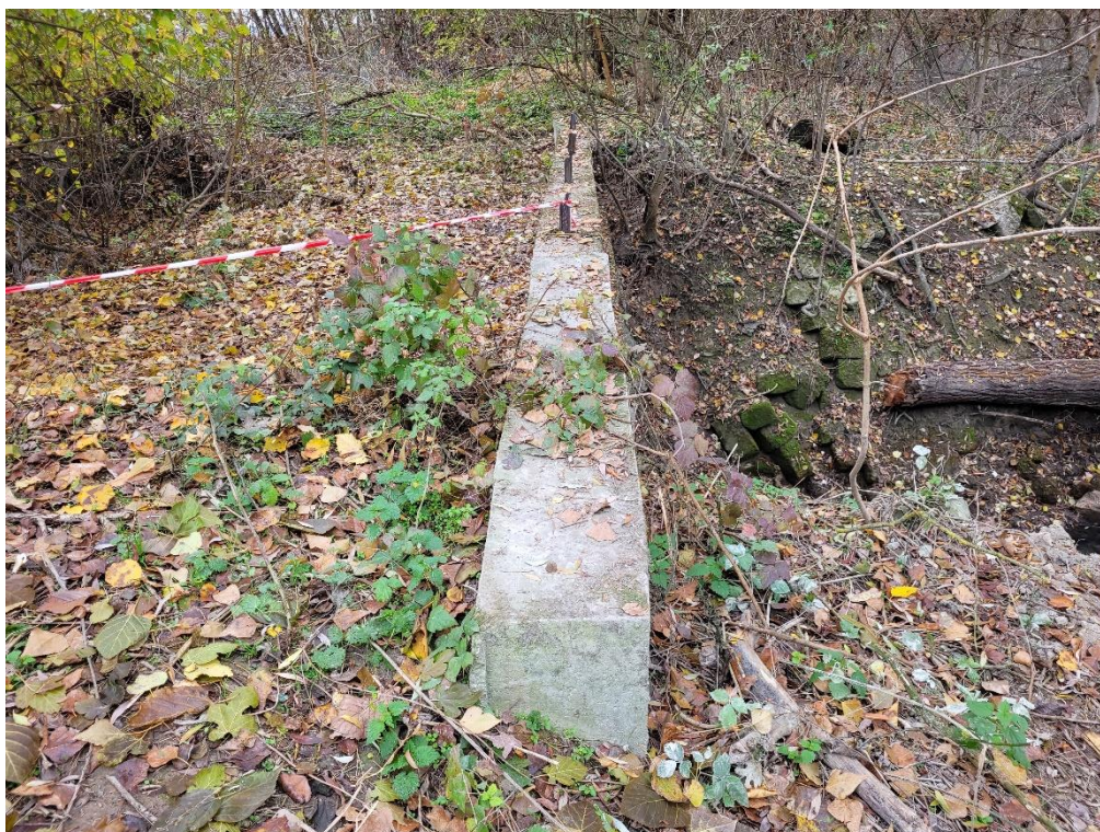
2. kép: Zsilip alvízi oldala, sérült támfal - hrsz: 0251
