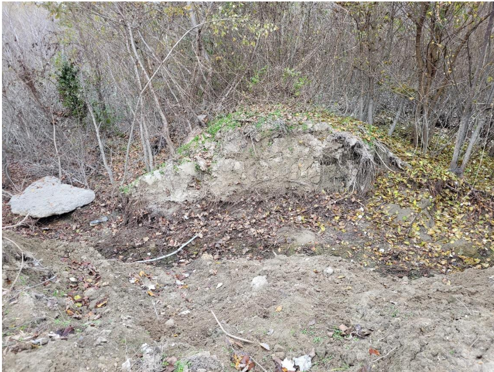
13. kép: Átszakadt árvízvédelmi töltés a Dunai Holtág mellett – hrsz: 0234/1
