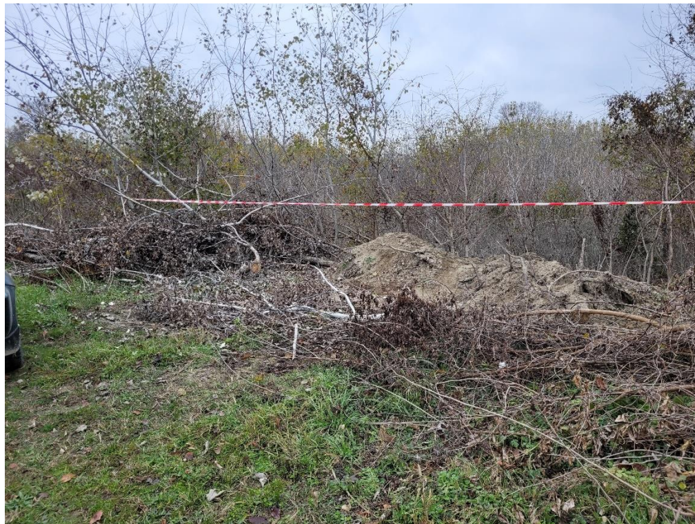
14. kép: Átszakadt árvízvédelmi töltés a Dunai Holtág mellett – hrsz: 0234/1
