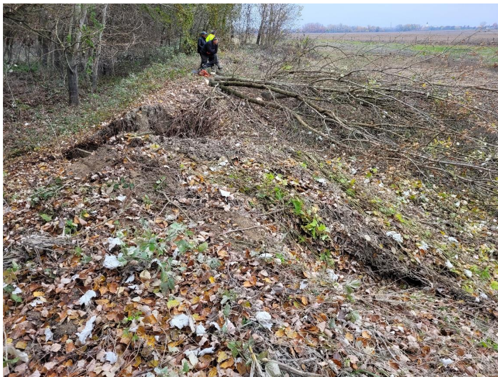
10. kép: Átszakadt árvízvédelmi töltés a Dunai Holtág mellett – hrsz: 0234/1
