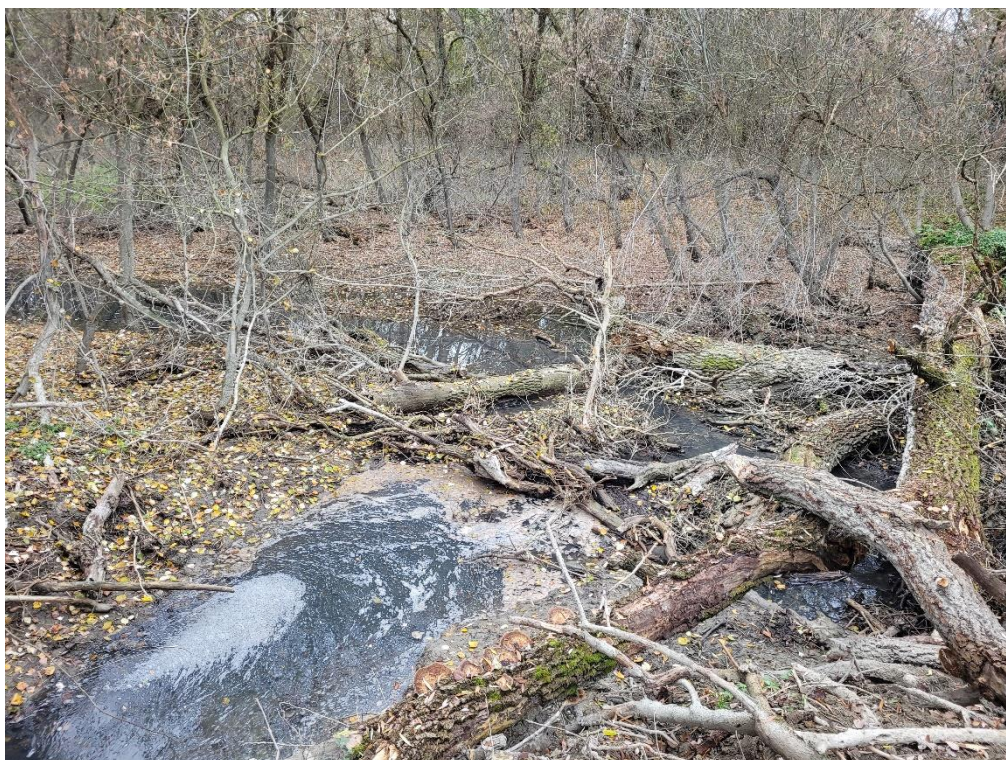
3. kép: Zsilip alvízi oldala, kifolyás a dunai holtág felé - hrsz: 0251
