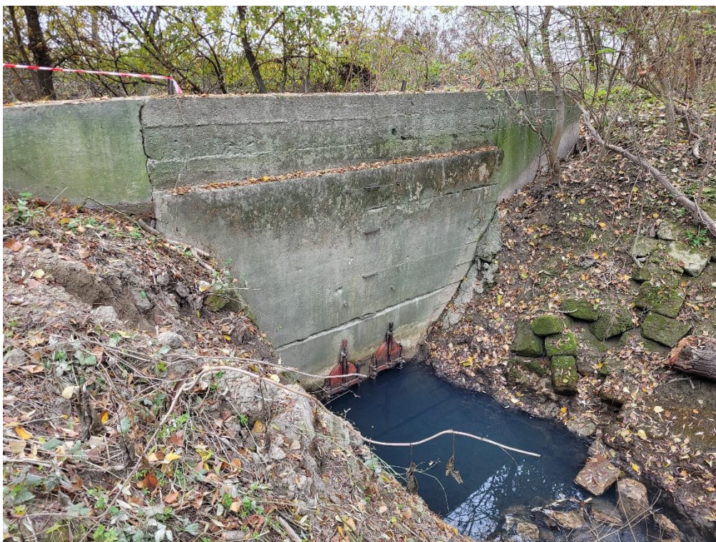
1. kép: Zsilip alvízi oldala, sérült támfal - hrsz: 0251
