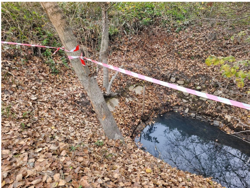
6. kép: Az iszapfogó Zsilippel ellentétes vége: a csatlakozó átereszt a földutat és a vízvezetékeket is keresztezi - hrsz: 0251
