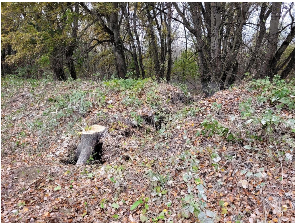
9. kép: Átszakadt árvízvédelmi töltés a Dunai Holtág mellett – hrsz: 0234/1
