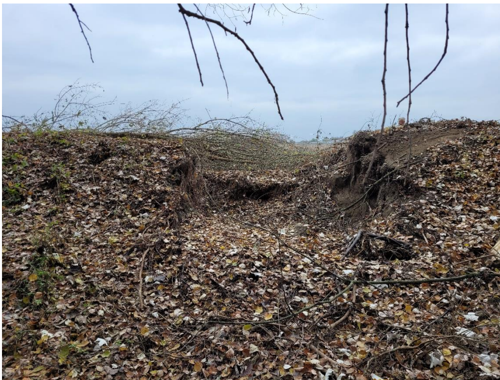
11. kép: Átszakadt árvízvédelmi töltés a Dunai Holtág mellett – hrsz: 0234/1
