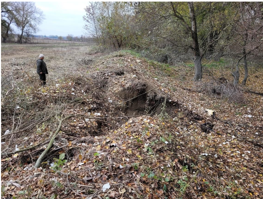
12. kép: Átszakadt árvízvédelmi töltés a Dunai Holtág mellett – hrsz: 0234/1
